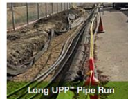
Long UPP™ Pipe Run
